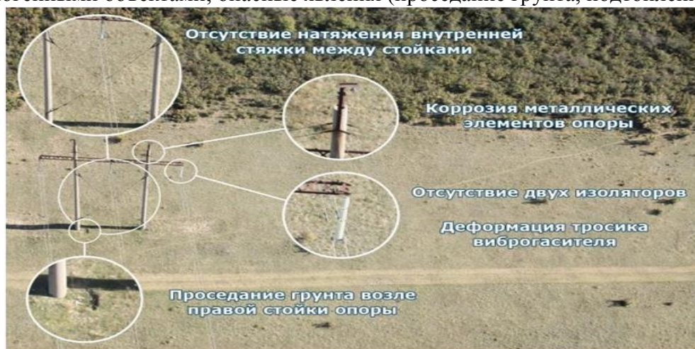
Рис.3. Обнаружение дефектов на ВЛ при помощи беспилотника.
